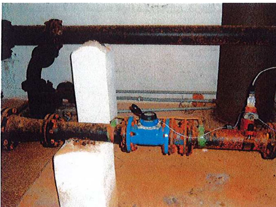
Foto 5: Armaturní komora – vodoměr na přiváděči do obce a vstup z chloračního zařízení
