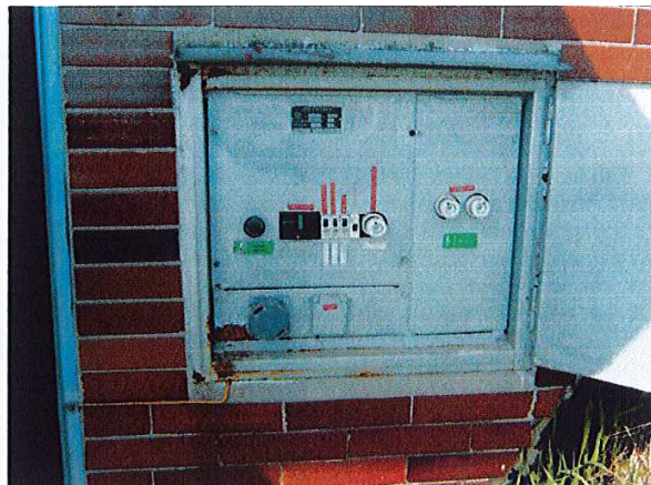
Foto 2: Rozvaděč u vodojemu Rohozná
