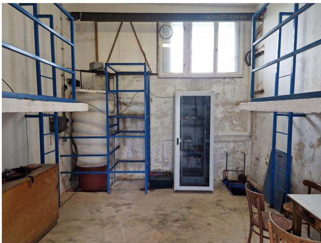
Foto 3: Vnitřní uspořádání vodojemu – vlevo – měření hladiny, vpravo – vstup do armaturní komory
