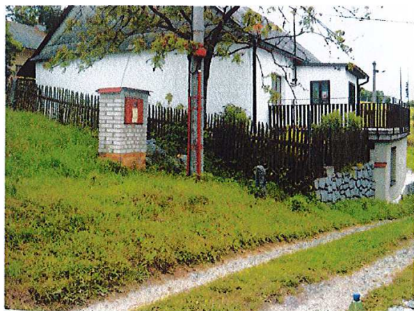
Foto 8: Rozvaděč v obci pod vodojemem
